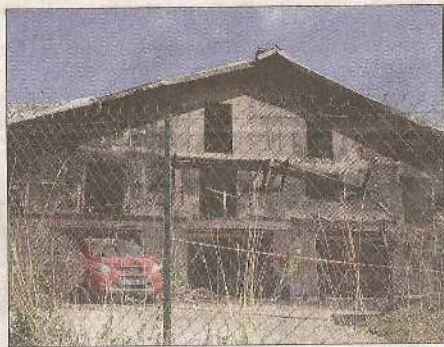
Le chalet l'Alpen Roc quelques heures après le sinistre. (Photo J.Die.)
